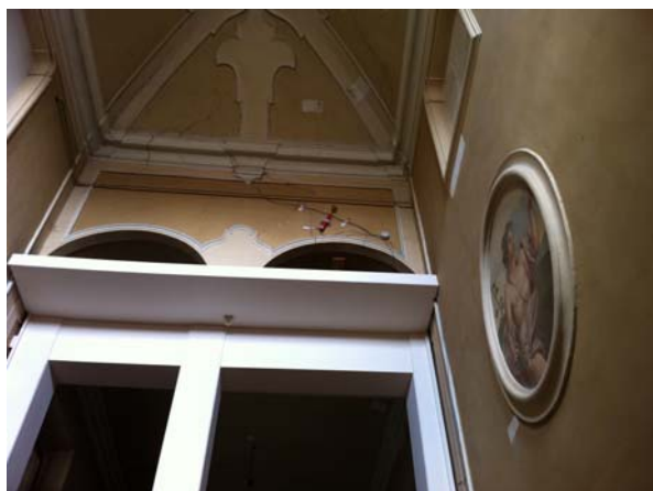
Installazione fessurimetro a barra su giunto di parete .
